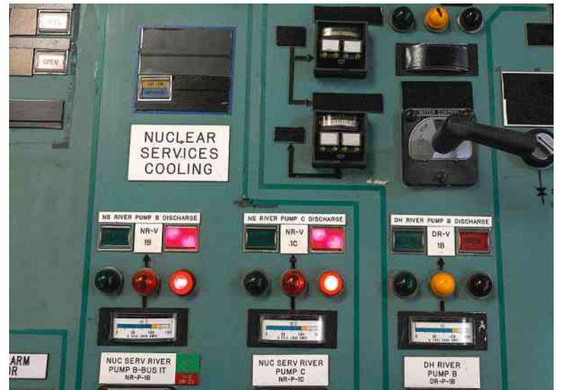
Sala de controle na usina nuclear Three Mile Island, em Middletown, Pensilvânia, Estados Unidos Shannon Stapleton - 16.out.24/Reuters
